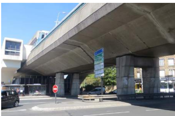
Déficit de végétation au niveau du secteur de la gare Source : Even conseil
